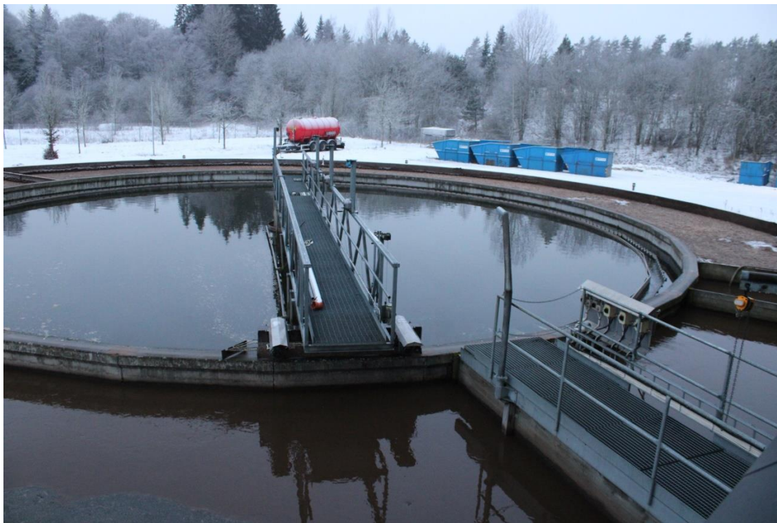
Figur 13. Foto av en cirkulär bassäng med biologisk rening. I mitten syns slutsedimenteringsbassängen och runt denna återfinns de olika zonerna. Foto: Njudung Energi.
