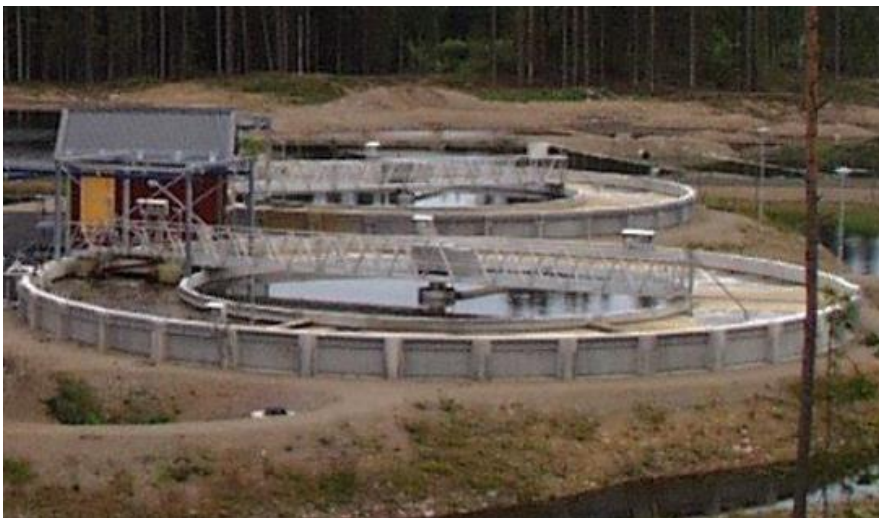
Figur 6. Bild över bassäng för biologisk reduktion av fosfor och kväve. Den yttre bassängen innehåller olika zoner (anaerob, anox, aerob, deox) och den inre cirkulära bassängen är slusedimenteringsbassäng.
